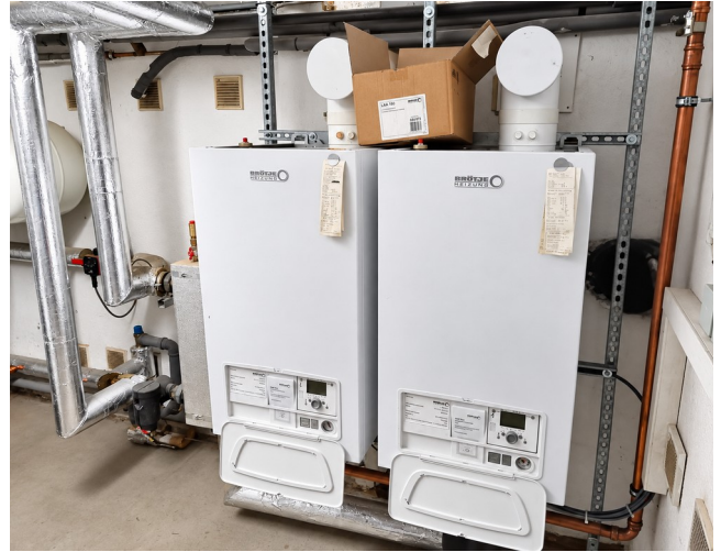
Gaszentralheizung mit zwei Wärmeerzeugern
